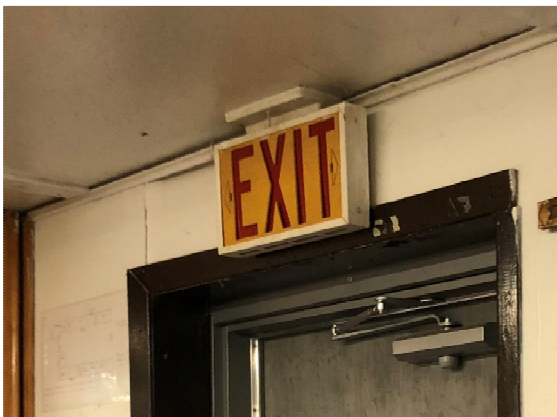
E11 – Exit Sign
