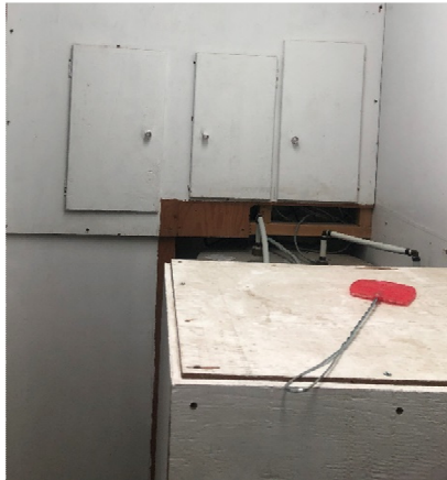
E1 – Electrical panels
